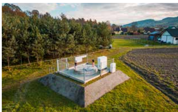
Przepompownia ścieków w Kąclowej
