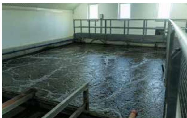
Oczyszczalnia ścieków w Kąclowej
